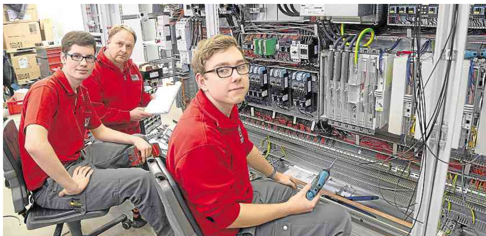
Während ihrer Ausbildung lernen Clemens Reichert (links) und Philipp Stuhlmüller (rechts) die komplette Fertigung einer Schaltanlage kennen. Beim ZeiLe-Projekt werden sie vom stellvertretenden Fertigungsleiter Bernd Speckhardt betreut.
